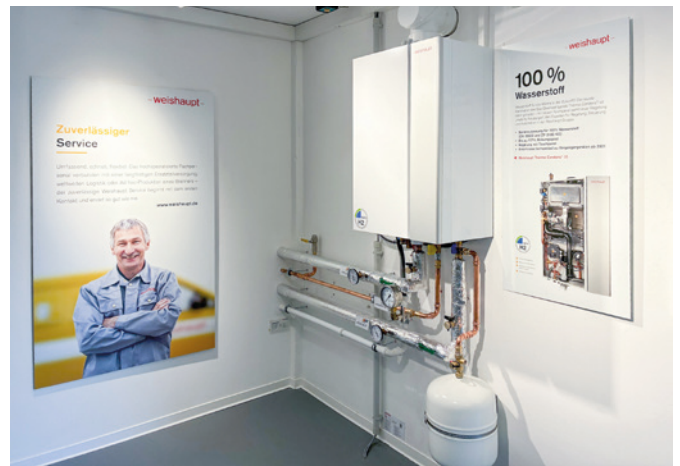
Das mit 100 % grünem Wasserstoff betriebene Brennwertgerät Weishaupt Thermo Condens® im Showroom des Projektes H2HoWi
