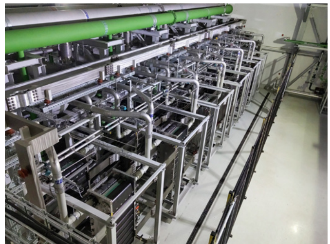
Mit 20 Megawatt Gesamtleistung ist der Trailblazer aktuell der leistungsstärkste Elektrolyseur Deutschland
