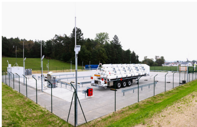
Das Gelände mit Trailer (rechts) und die H 2 -Einspeiseanlage (links): Hier wird der Wasserstoff angeliefert und der Druck reduziert, um anschließend mit 250 Millibar in das Gasnetz eingespeist zu werden
