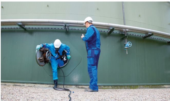
Bild 1: Ausstieg aus einem Mannloch. Bei Freigabemessungen bieten Geräte und Pumpe mit einer Zulassung für Ex-Zone 0 die größtmögliche Sicherheit
