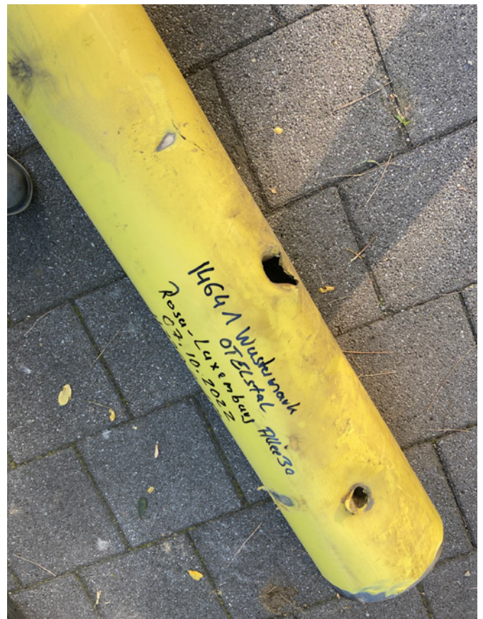
Bild 2: Diese Gasleitung der NBB ist durch eine beim Glasfaserausbau verwendete Erdrakete getroffen und beschädigt worden
