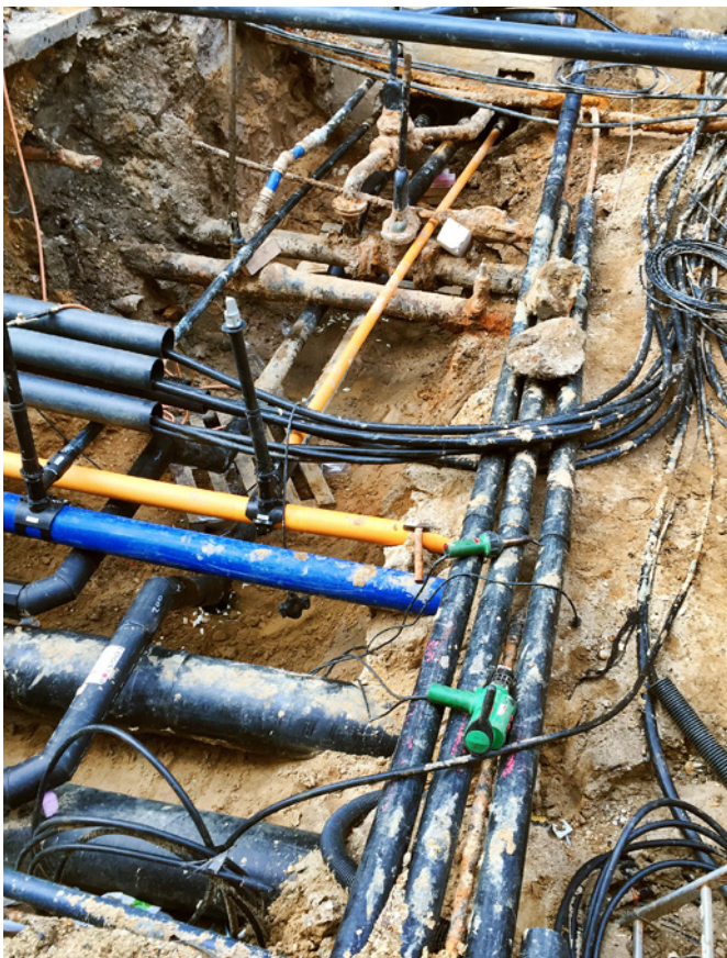
Bild 1: Viele Medien wie Strom-, Gas- und Wasserleitungen sind im Erdreich verlegt. Bei Bauarbeiten ist dies immer ein Risiko
