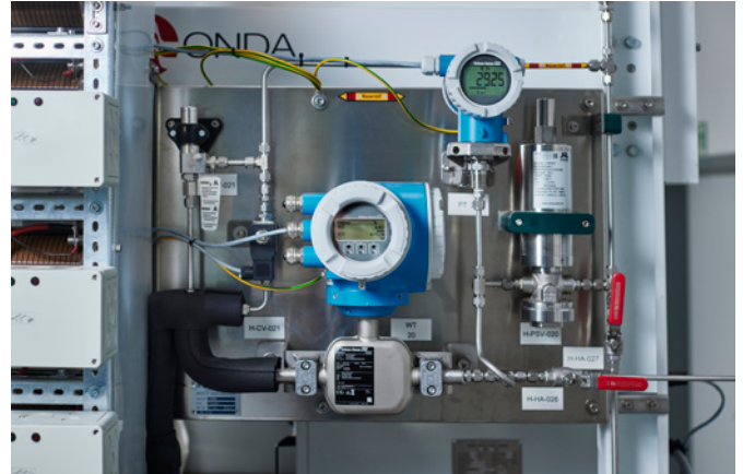
Bild 3: In der Testanlage sind auch weitere Messinstrumente – hier Durchfluss und Druck – verbaut
