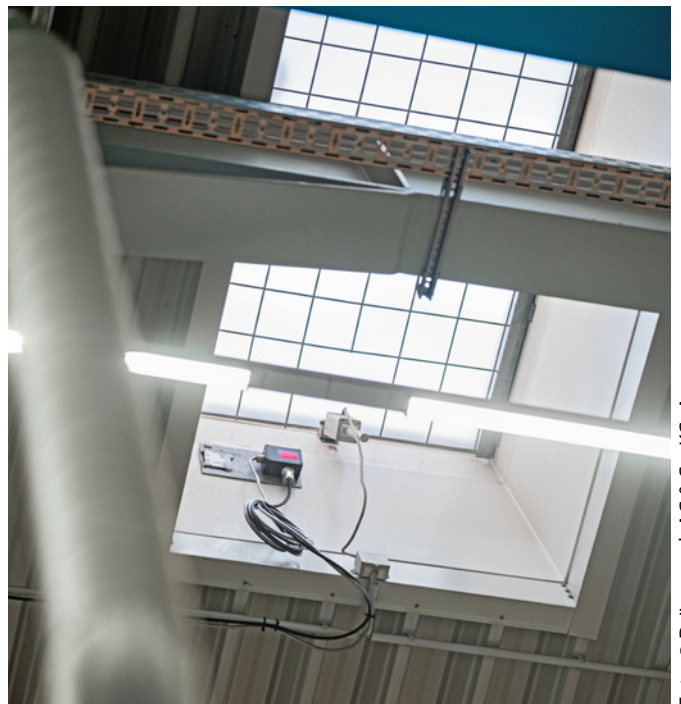
Bild 2: Da sich Wasserstoff besonders im Deckenbereich ansammelt, sollte die Gaswarntechnik auch dort montiert werden
