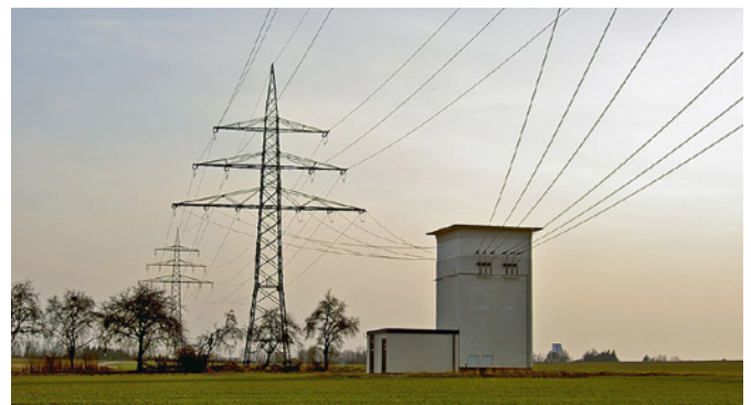
Bild 2: Hochspannungsleitung im Normalbetrieb
