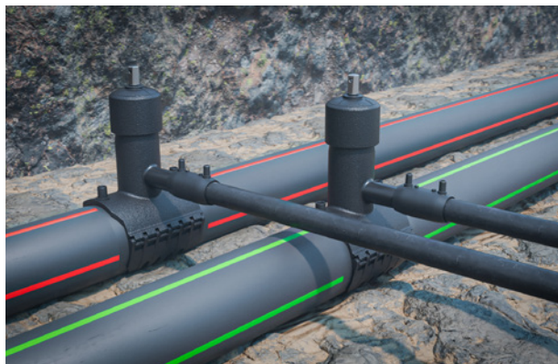
Bild 4: Links Druckanbohrventil (DAV) Fabrikat AGRU als Hausanschlussarmatur; rechts DAV-Ausbläseereinheit Fabrikat FRANK zum Befüllen und Entlüften des Rohrsystems
