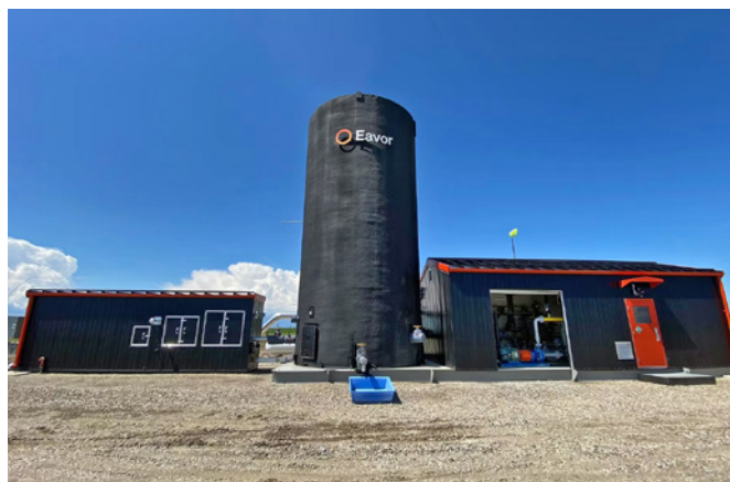
Bild 3: Demonstrationsanlage des Eavor Loop im kanadischen Alberta, der Prototyp Eavor-Lite™
