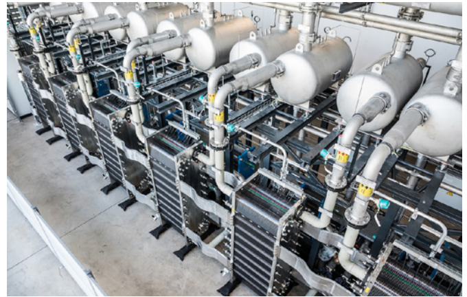
Bild 2: Wasserstoffherzeugungsanlage H2Future Linz
