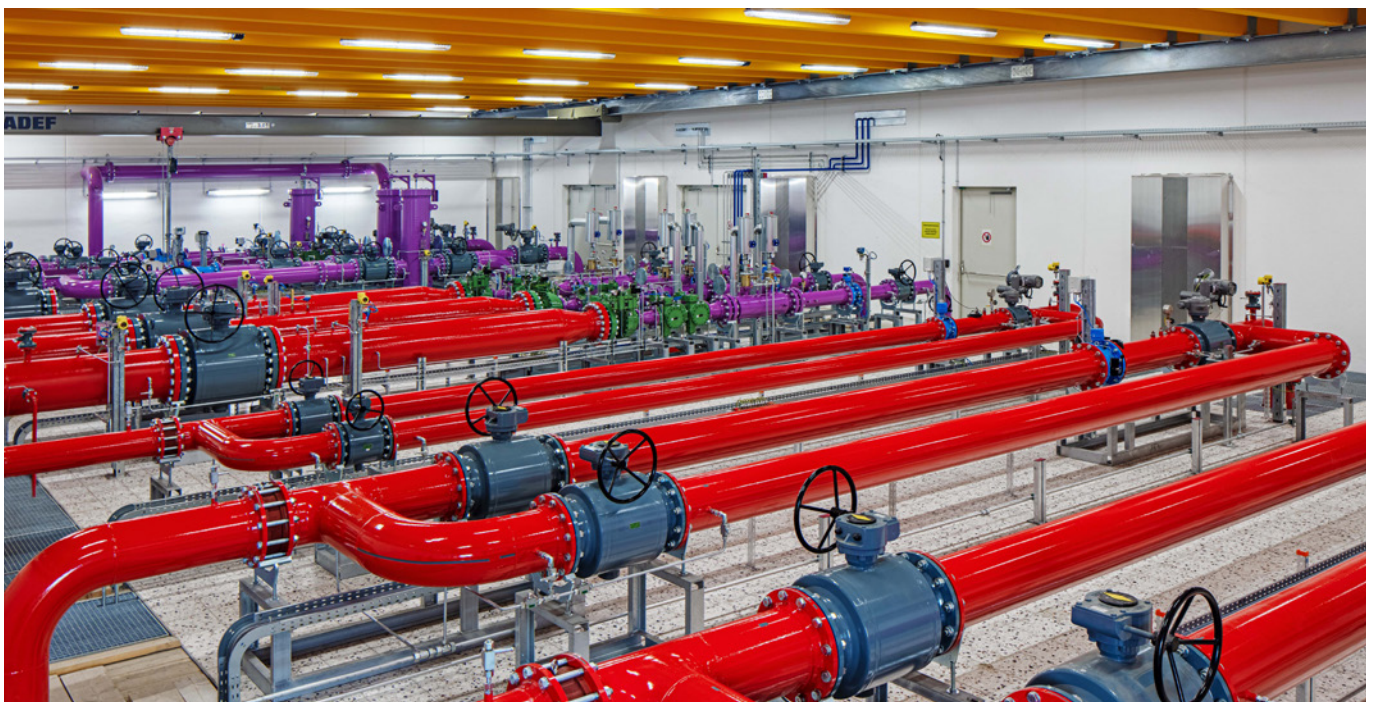
Bild 1: GDRM-Anlage Netzknotten Stuttgart
