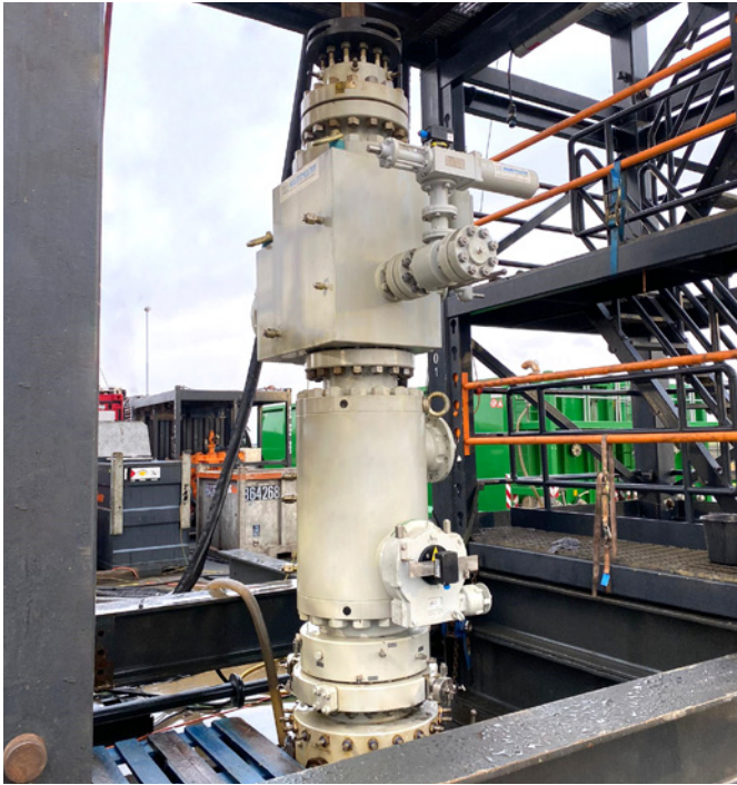
Bohrlochkopf einer der ersten Testkavernen für Wasserstoff
