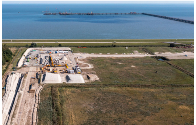
Die Anbindungsleitung WAL verschafft 12,3 km Energiesicherheit
