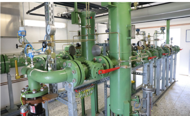
Bild 2: Gasbezugsstation in Hartenricht nahe Schwandorf: Dort wird immer mehr Biomethan ins Erdgasnetz eingespeist
