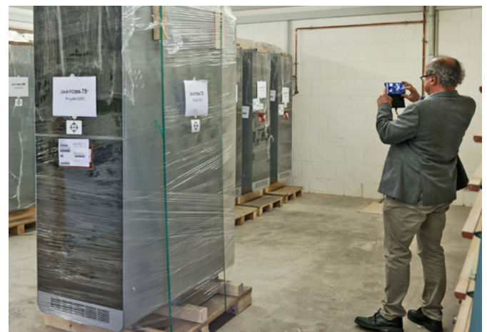
Bild 2: Prof. Peter Wasserscheid begutachtet die gelieferten SOFC-Module in der künftigen Energiezentrale des Krankenhauses
