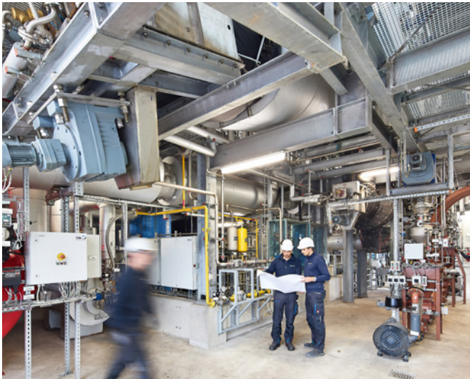
Mit der Gasifizierung von Klärschlamm nach dem SynGas-Verfahren bietet KOPF SynGas einen Ansatz zur Verwendung von Klärschlamm als Brennstoff
