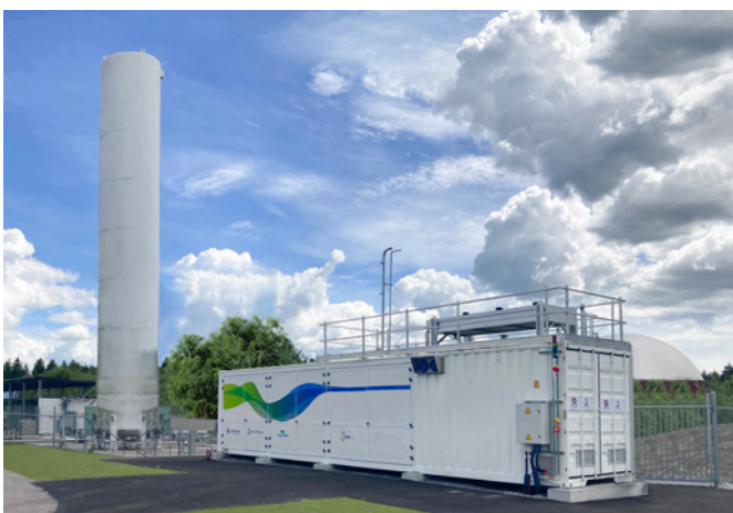
Bild 2: Verflüssigungsanlage in Schweden mit einer Produktionskapazität von 2t/Tag Bio-LNG
