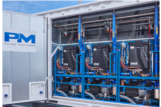
Bild 2: Die Kernkomponenten des Brennstoffzellen-Kraftwerks HyShelter 240 bilden drei Brennstoffzellen-Systeme PM Frame S43 Foto: © Proton Motor
