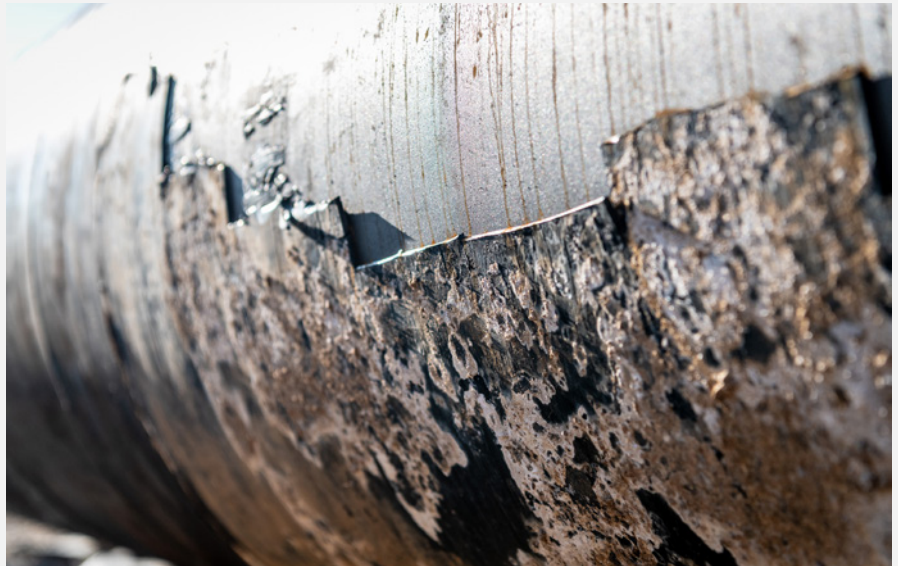
Bild 1: Oberflächenentschichtung an einer Gas-Pipeline
