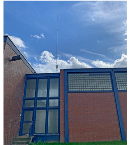
Bild 1: LoRaWAN Antenne auf dem Dach des Umspannwerks
