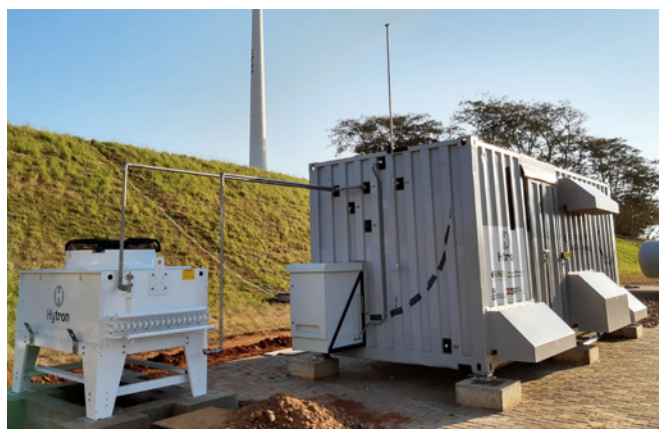
Bild 1: Hytron Elektrolyseur von Außen
