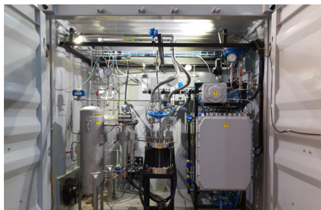
Bild 2: Hytron Elektrolyseur von Innen
