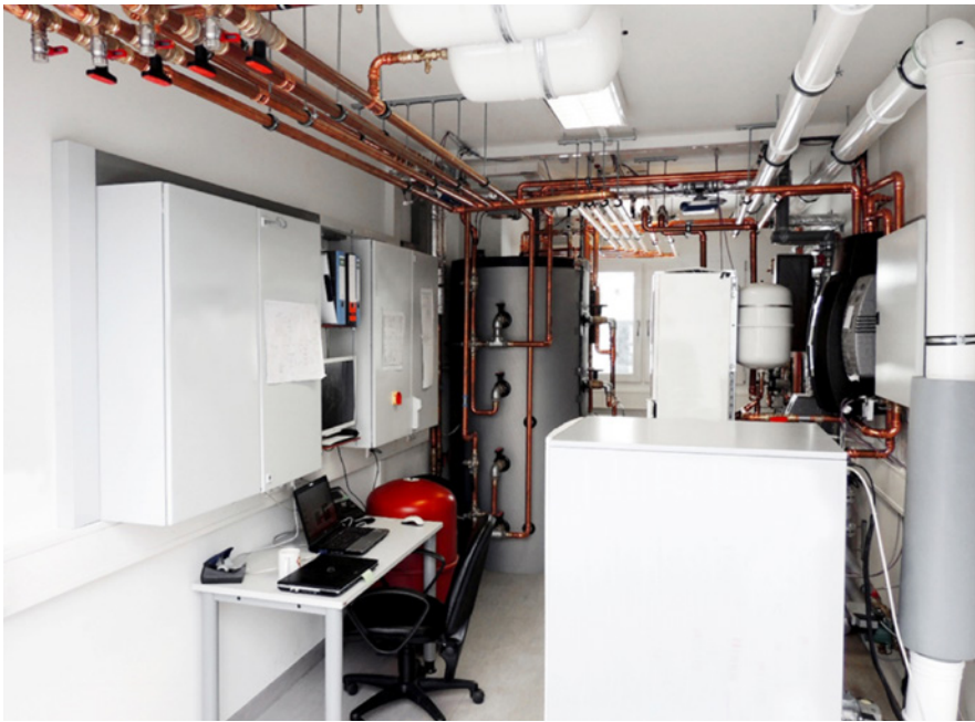
Bild 5: Die Hochschule Landshut errichtete einen Prüfstand mit einem BHKW, einer Gasbrennwert-Heiztherme, einem elektrischen und einem thermischen Speicher sowie einer Frischwasserstation (Foto: Hochschule Landshut)
